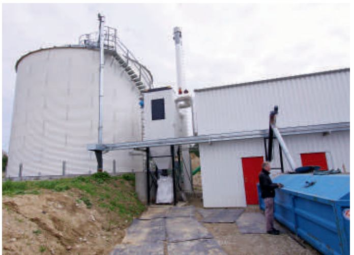
Die neu gebaute Anlage besteht aus Brennstoffsilo (links), Brennstoffaufbereitung (Mitte) und Kesselhaus (rechts), davor der Container für die Asche. Fotos: Meier (10), Werkstätten Heating-Systems (4)
